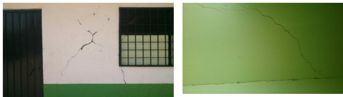
Agrietamiento en Escuela Secundaria de Tlatlaya (Cabecera Municipal)
